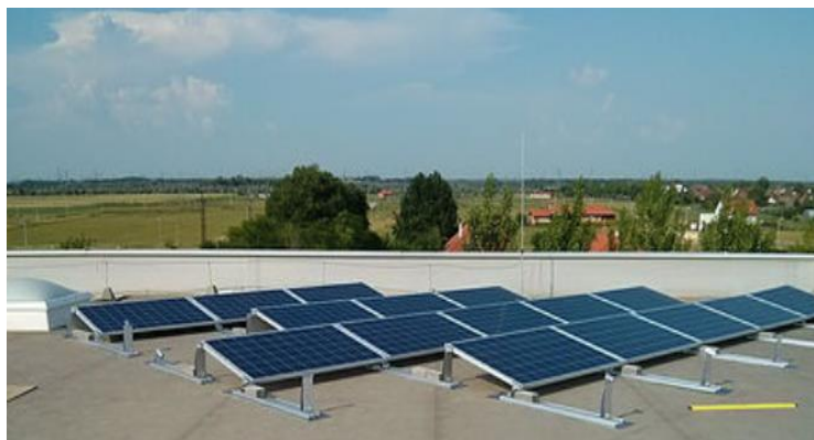
Napkollektorok ipari épület tetőzetén
