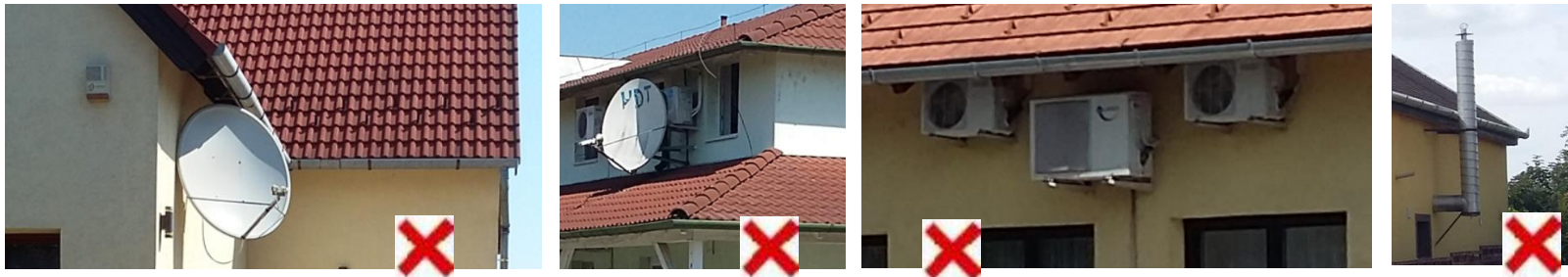
Utcai homlokzatra helyezett klímaberendezések, falból kilógó kémény és vezetékek dzsungele
